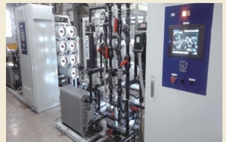
超純水製造装置
